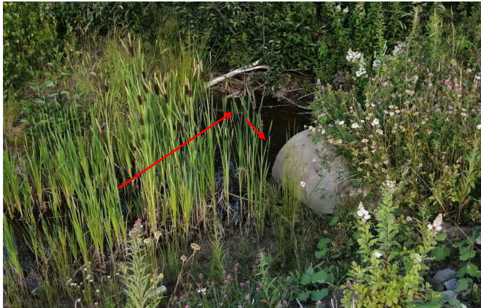
Photo 6 : Tuyau qui draine l'eau du canal le long du boulevard Industriel et l'achemine sous le boulevard vis-à-vis la nouvelle rue.
