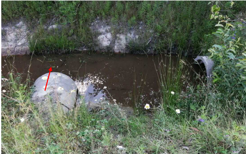
Photo 7 : Tuyau qui amène l'eau de la propriété sous le boulevard Industriel vers un canal le long du côté ouest du boulevard.
