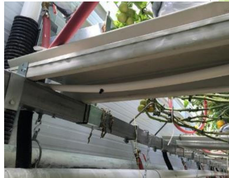
Tuyau rigide de distribution de CO2
