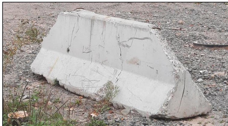
Figure 10-3 : Exemple de barrière non acceptable
